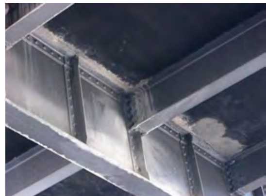
写真 4-5 横桁の上フランジとコンクリート床版下面の間に遊離した石灰
