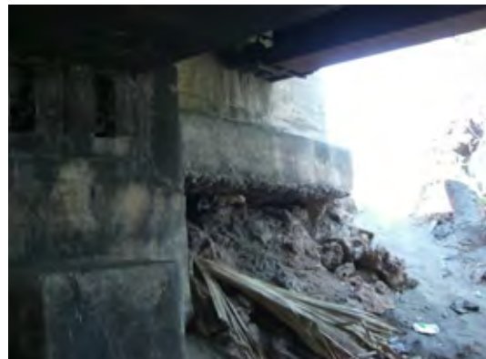
写真 4-7 雨水により洗掘されコンクリートが宙に浮いた歩道部基礎
