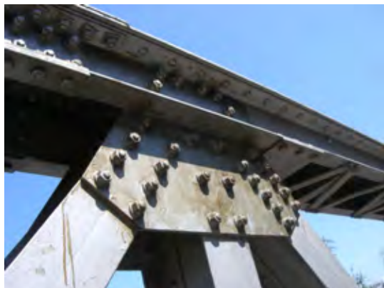
写真 4-4 建設当初のリベットとその後取り替えられたボルトの混在
