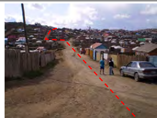
ゲル等集落密集地における送配水管敷設区間。電柱、民家塀等を極力避けた線形の設定と施工中の配慮が必要である。
