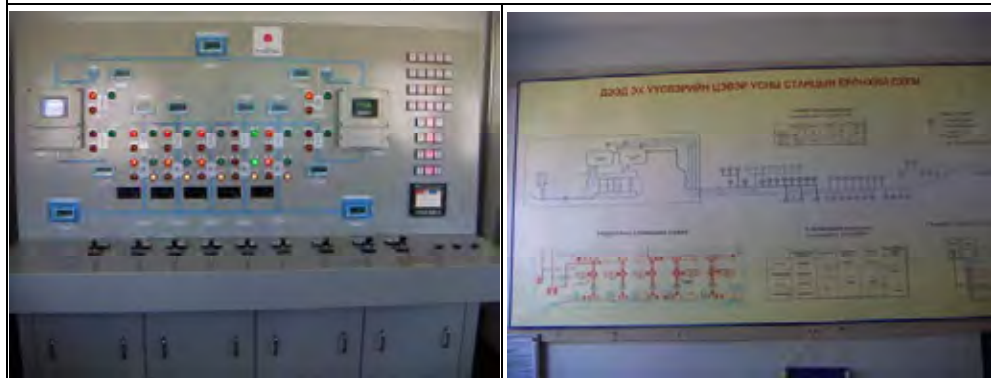
写2-1.13 上流水源遠方監視操作設備 (1箇所落雷により取水ポンプの遠方操作ができない)
