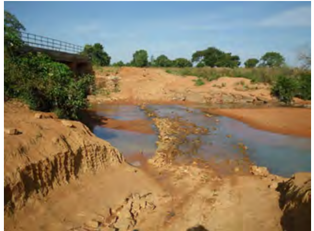
4) 地方道路の河川横断部分 サバネス州東部 2009/11/12
