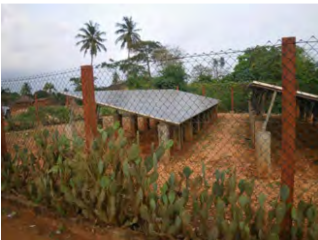
3) 我が国「村落給水計画（1997～2000、第 4 次無償）」 で建設されたソーラーシステム式レベル 2 施設、 稼動中、パネル部 マリタイム州 Agomé 村 2009/11/02
