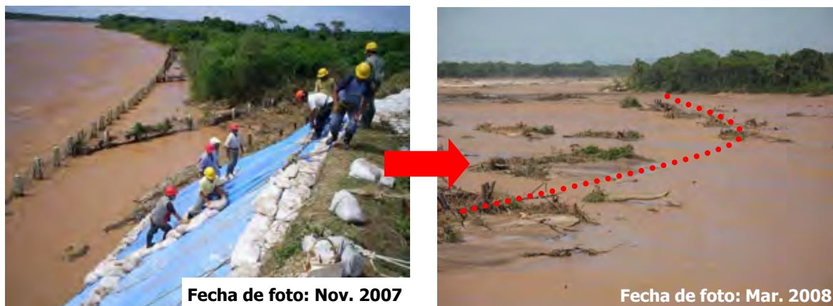
Figura 2-2-5 Erosión de la orilla y destrucción de las obras de encauzamiento
