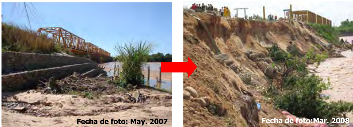
Figura 2-2-4 Destrucción del terraplén de acceso al Puente en el lado aguas arriba
