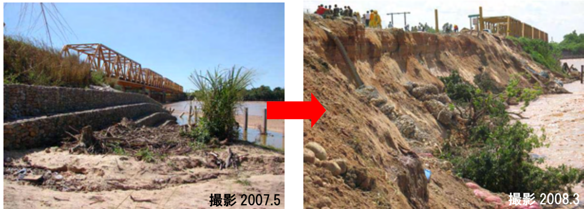
図 2-3-4 取付道路上流側の崩壊
