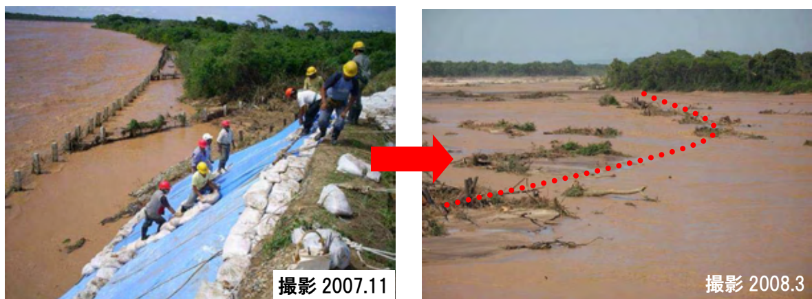
図 2-3-5 河岸侵食と水制の倒壊
