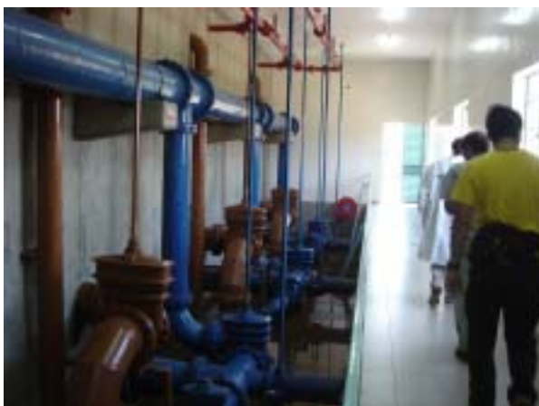
急速ろ過池管廊
