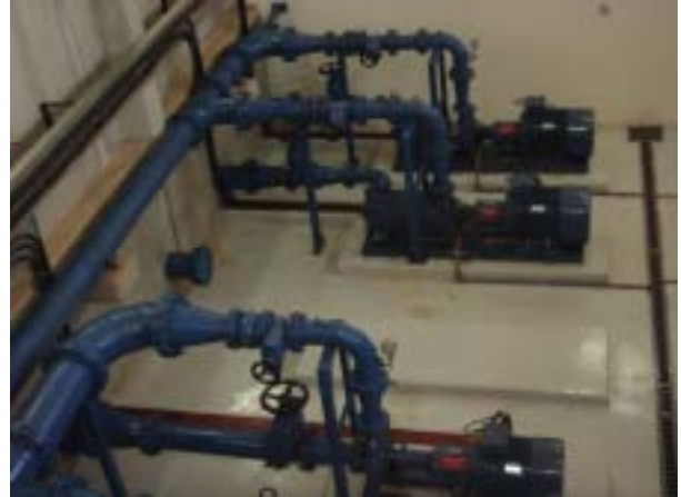
洗浄用水揚水ポンプ
