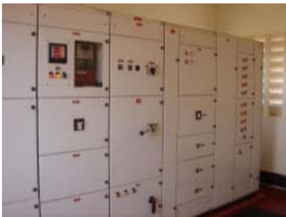
電源コントロールセンター
