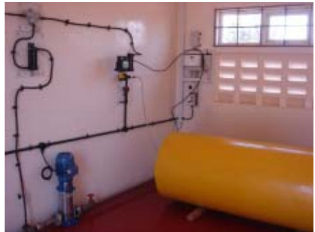
1トンポンベによる塩素注入
