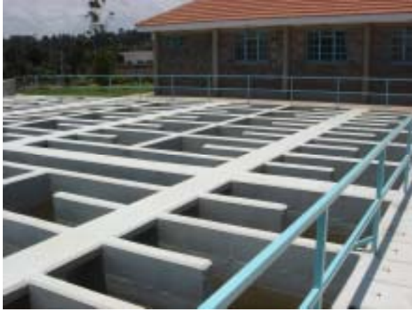
新設う流式フロック形成池
