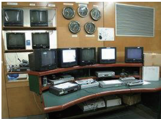
1. USP ラウザラ本校・メディアセンター ビデオ放送コントロール室
