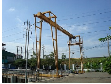
新設したトンブン排水機場
