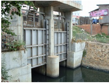
トムヌップテック排水樋管
