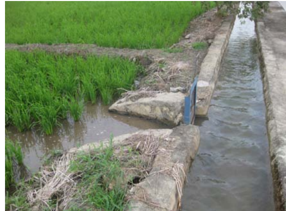
3次水路コンクリートライニング等を整備した リンコンダム試験圃場
