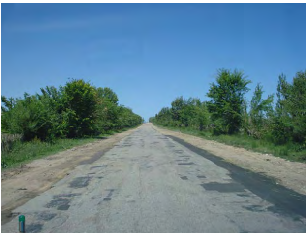
イシククリ周回道路南側 カラコルから 110km 付近。20 年以上前の舗装で全体的にポットホール補修跡が多い。
