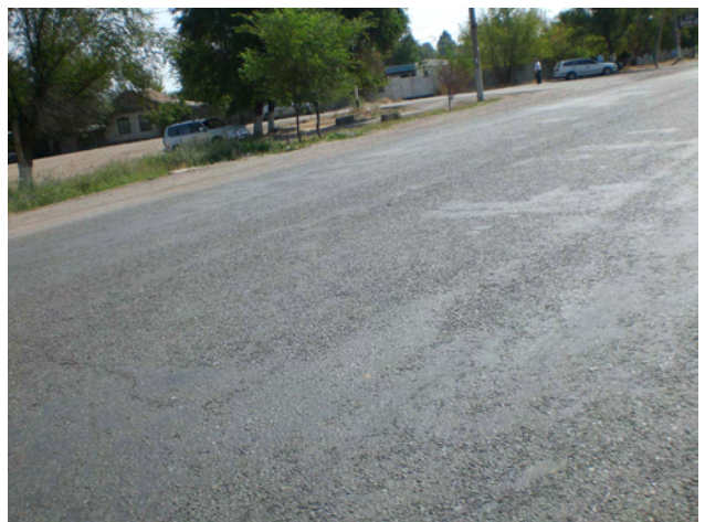
BNT 道路 トクモク付近 チップシールの砕石が飛びアファルトが浮いている。
