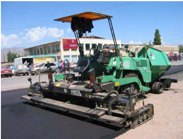
「ナリン建機道路維持管理用機材整備計画」（無償）にて調達され、再舗装作業中のアスファルトフィニッシャー
