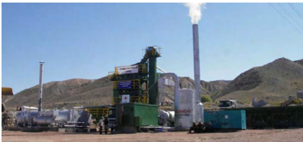
15. アスファルトプラント
