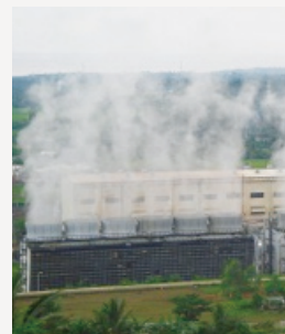
ティウィ地熱発電所
