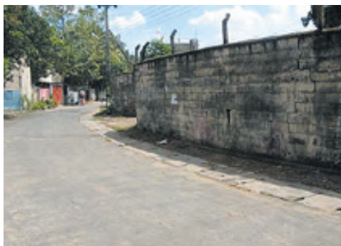
維持管理の容易な蓋つきの側溝(アッティディヤ)
