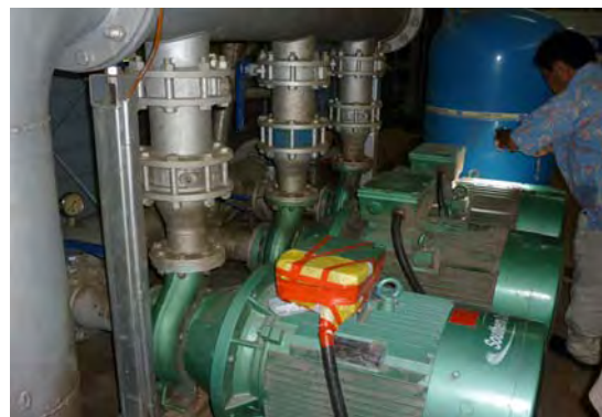
EUの協力によるコングライ湧水ポンプ場、24時間フル稼働している
