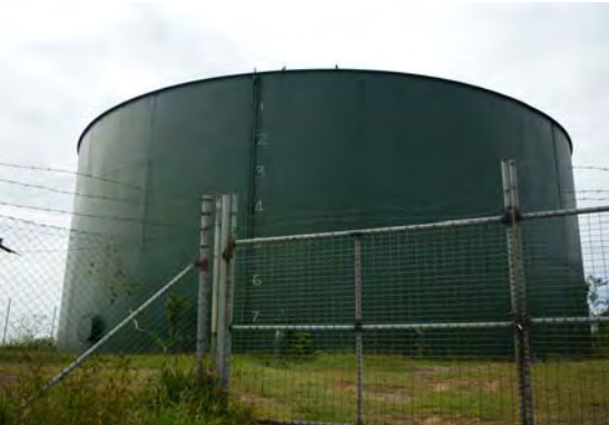
1997年、EUの協力によるコンビト配水タンク、水位が常に低く、そのまま配水されることもある
