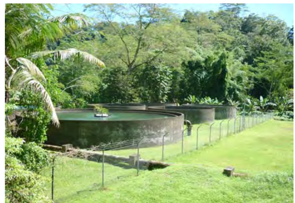
粗ろ過池 沈殿池はない
