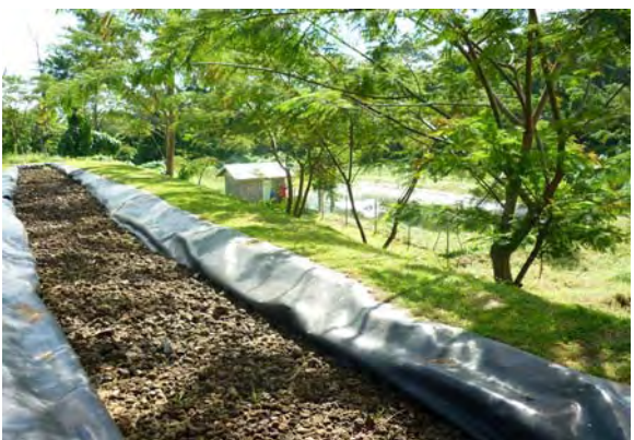
アピアのごみ埋立最終処理場 無償資金協力で設置 した汚水のろ過施設(福岡方式)
