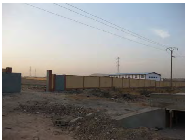
プロジェクトサイト内の状況 (マリ側予算で敷地外周塀の工事が実施されている)
