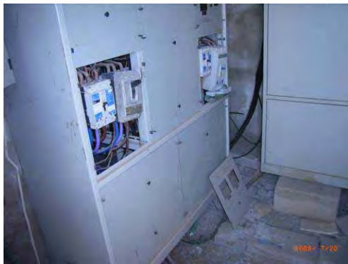
サブステーション内部の老朽化した盤
