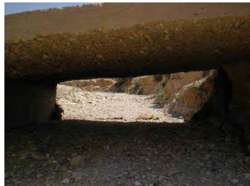
Box Culvert 取り付けスラブ下部の洗掘した空間を流路としている
