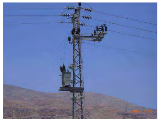
3300V 送電線、鉄塔、変圧器
