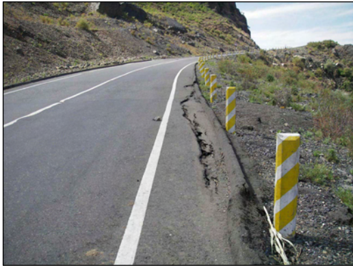
道路谷側の路肩に発生している亀裂、地盤の動き（地すべり）に追従して、谷側に舗装が引っ張られたために生じている。
