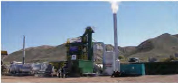
19. アスファルトプラント
