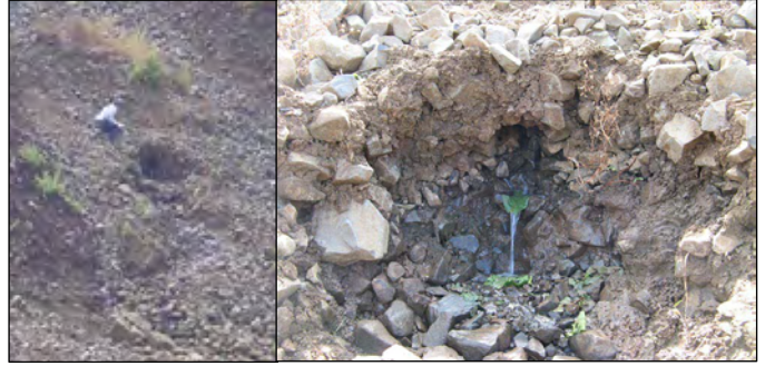
道路山側の斜面から流れ出てくる水、水抜き水平ボーリングの対象である。
