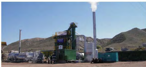
19. アスファルトプラント
