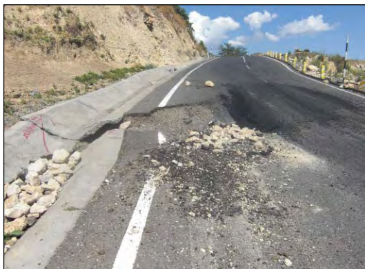
道路が大規模な地すべり地域を通過しているため路面に段差が生じて円滑な通行が阻害されている。
