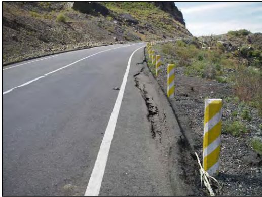
道路谷側の路肩に発生している亀裂、地盤の動き（地すべり）に追従して、谷側に舗装が引っ張られたために生じている。
