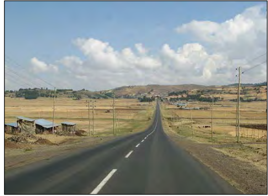
アディスアベバ郊外の国道3号線改修区間、平坦な丘陵部を通過して走行性は良好である。
