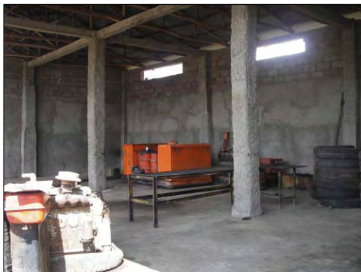
ガレージ内部、調達機材の整備機材を設置する予定
