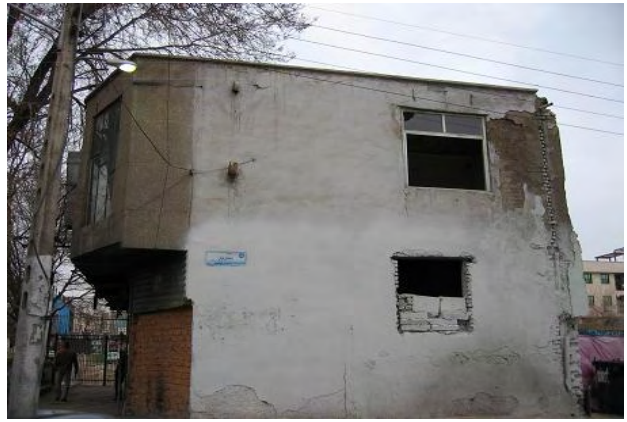
セットバック住宅の側面からの撮影 2 階部分は床面積を維持するため、せり出すように建設されているのが現状
