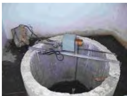
写真 2-2-6 キロフダム流量演算式水位計
