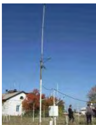
写真 2-2-18 自動データ受信／送信装置
