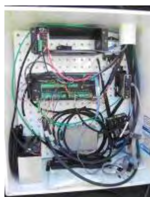
写真 2-2-19 受信／送信装置内部機器
