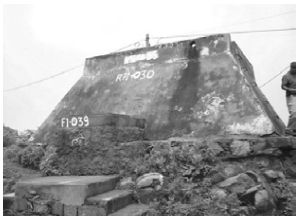
写真-1 既存タンク
