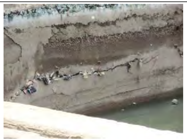
写真-2.15 左壁の状況(2) (ひび割れが認められる)
