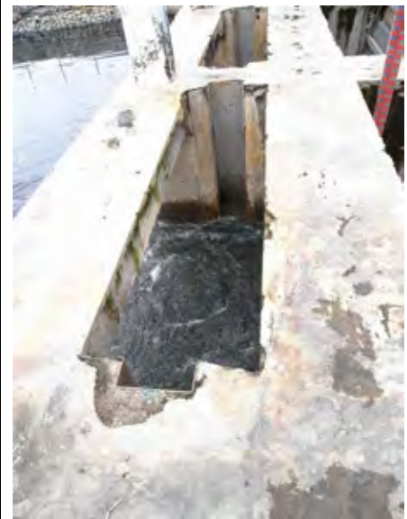
写真-2.11 吸い込み口前面からの 海水の噴出し(Pump No.1)
