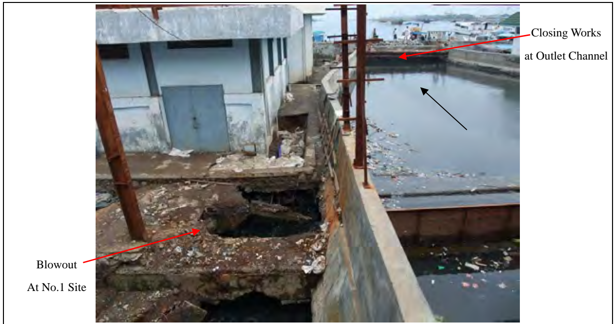
写真-2.9 パイピング破壊の状況
