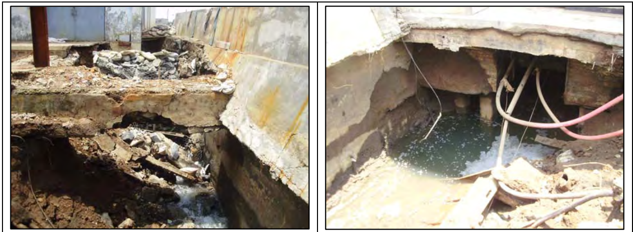
写真-2.16 パイピング破壊の状況
