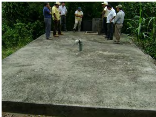
ベテル村・上水道サブ・プロジェクト 貯水タンク
