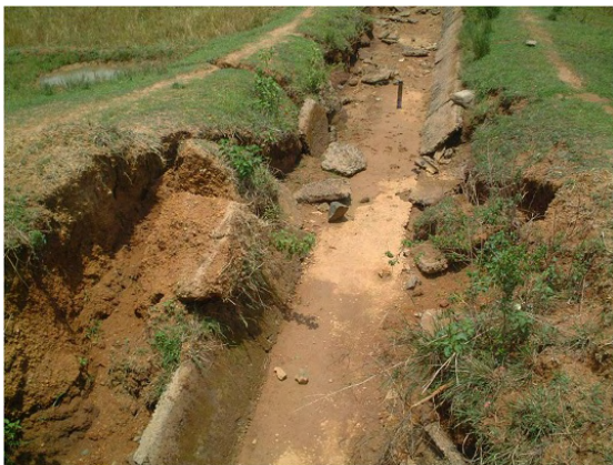
図 6 損傷した水路
