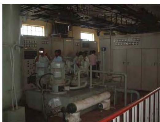
図 10 発電所内の様子
