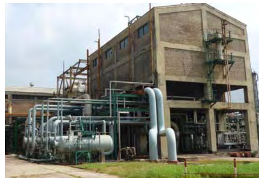
図 2：肥料工場内のアンモニアプラント
