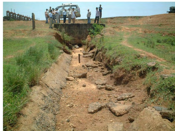
図 7 損傷した水路
