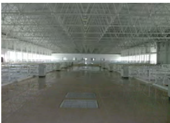
浄水施設 (フロック形成池、沈殿池、ろ過池)
