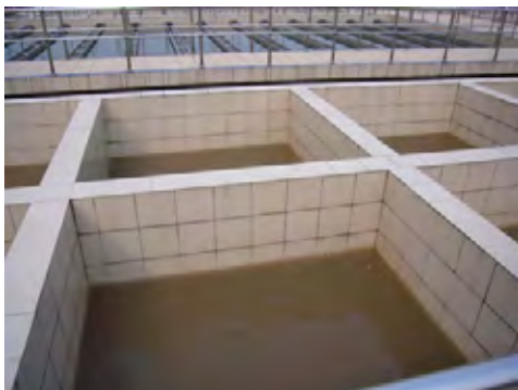
豊収壩浄水場内 沈殿池
