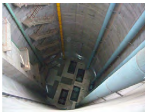
豊収壩浄水場内 着水井
