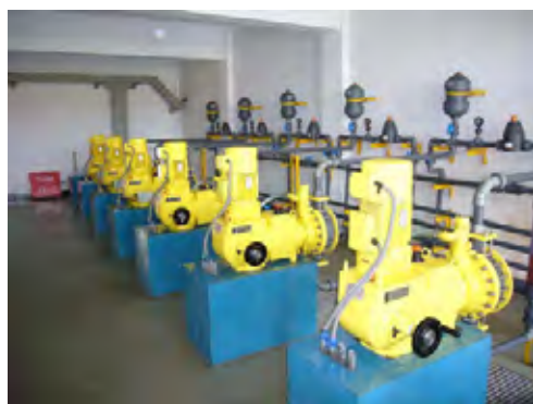
豊収壩浄水場内 塩素注入施設
