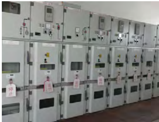
古冶区自来水公司の 本事業により整備された配電盤
