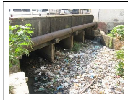
ゴミの詰まった排水路 (サーペンタイン開架式排水路)
