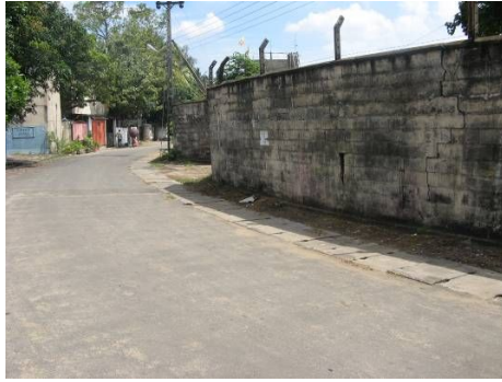
維持管理の容易な蓋つきの側溝(アッティディヤ)
