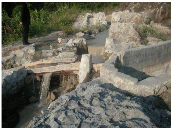
ルヌン川上流の採砂現場 砂を掘った後の泥で濁った水 がルヌン川に流れ込む。
