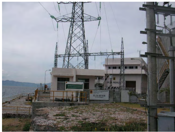
トバ湖畔に立地するルヌン水力発電所
