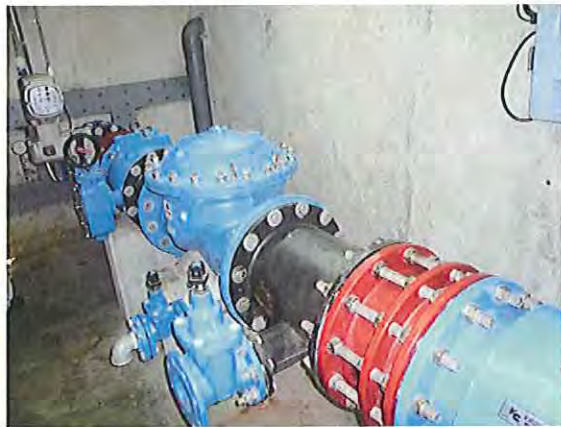
遠隔操作される配水バルブ
