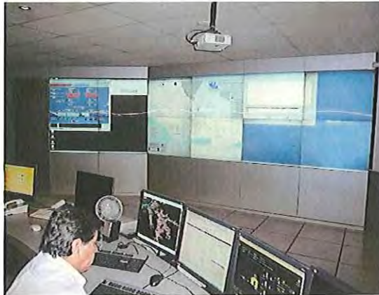
リマ上下水道公社本部の遠隔操作室
