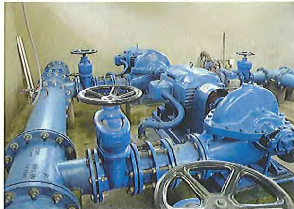
配水ポンプ（リマ市リマク区）
