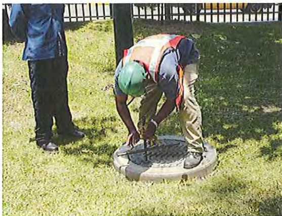
公園に設置された地下配水バルブ室への入口
