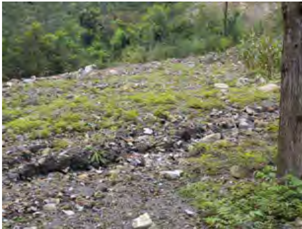
上部から流出した土砂が 勾配約 16^{\circ} で耕地に堆積している
