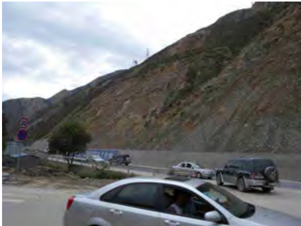
向かって左側の崩壊地
