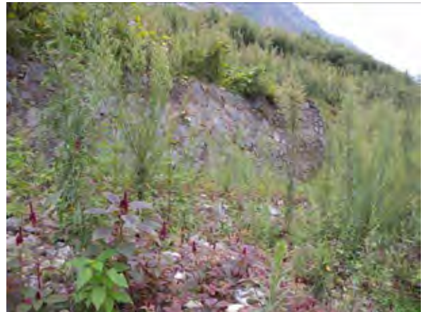
崩壊の下方部で見られる既設石積土留工
