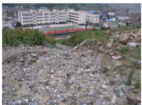
降雨の際に上部からの水が集中して流下し 洗掘された溝
