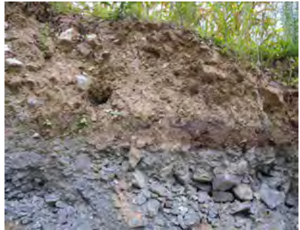
崩壊の下方部で見られる堆積した土壌の断面
