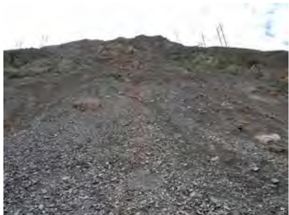
向かって右側の崩壊地の上部
