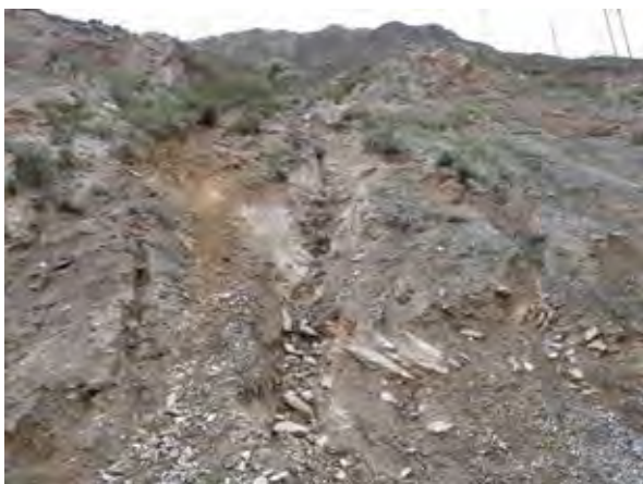
崩壊地やや左側の上部
