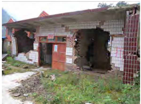
地震で破壊された家屋
