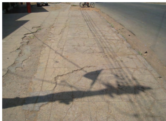
写真 3-2-1 タイル式舗装破壊状況
