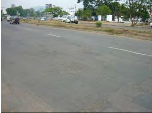
STA 48+00付近(上り線側) 補修(パッチング)した後から、クラックが 発生しており、路盤が損傷していることが判る。
