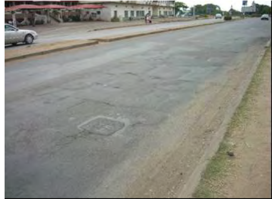
STA 53+00付近(上り線側) 到る処で維持管理(補修)されているものの、 道路の平坦性が保たれていないことから、 整備が必要。
