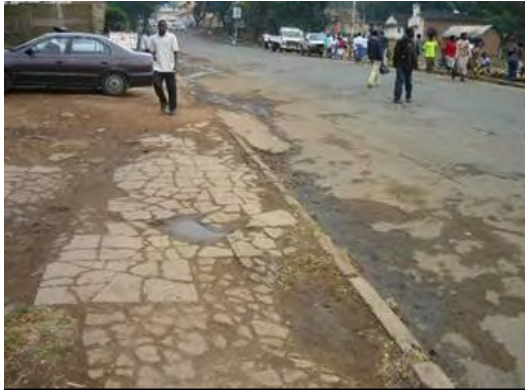
STA 72+00付近 車輛が歩道部に乗り上げるため、コンクリート タイルが多数破損している。 また、排水施設が機能していないため、水が 溜まり不衛生な状態である。
