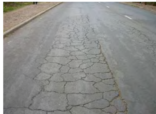
ブランタイヤ市内マカタ道路 施工から年月がさほど経っていないにも係わらず 亀甲状のクラックが発生している。
