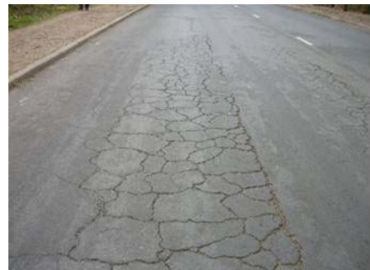
ブランタイヤ市内マカタ道路 施工から年月がさほど経っていないにも係わらず 亀甲状のクラックが発生している。
