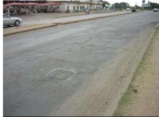
STA 53+00付近(上り線側) 到る処で維持管理(補修)されているものの、道路の平坦性が保たれていないことから、整備が必要。
