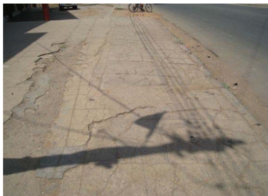
写真 3-2-1 タイル式舗装破壊状況
