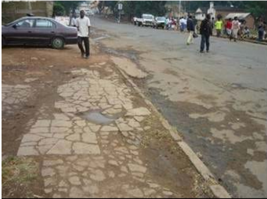
STA 72+00付近 車輛が歩道部に乗り上げるため、コンクリート タイルが多数破損している。 また、排水施設が機能していないため、水が 溜まり不衛生な状態である。
