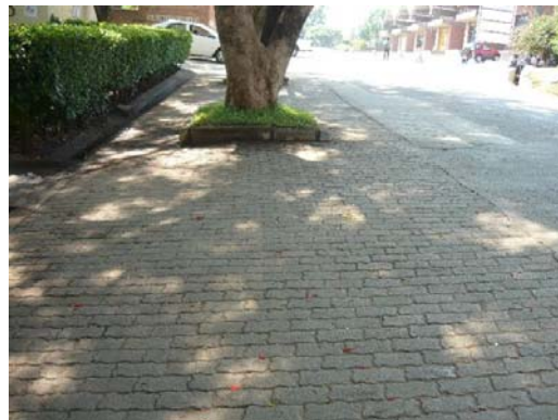
写真 3-2-2 インターロッキングブロック式舗装
