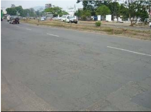
STA 48+00付近(上り線側) 補修(パッチング)した後から、クラックが発生しており、路盤が損傷していることが判る。
