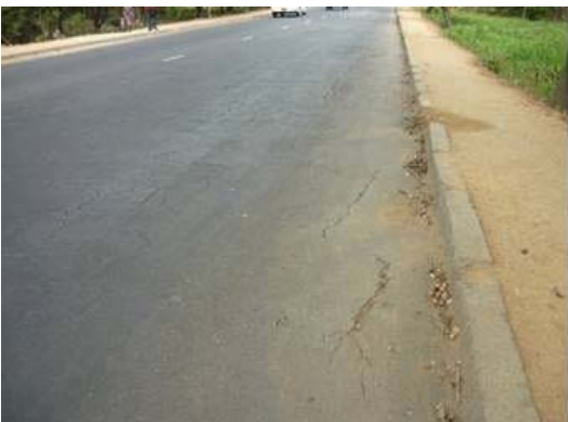
ブランタイヤ市内マカタ道路 World Bankの援助で2004年に施工した。 道路にはクラックが発生し、排水設備も備わって いない。
