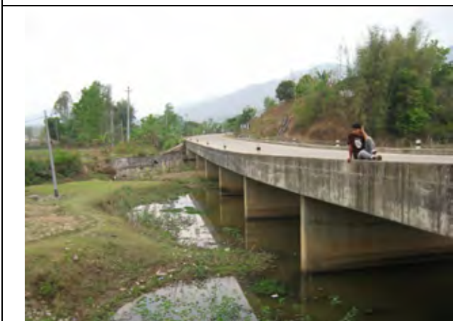
写真-9：シンズリ道路第2工区建設事業で建設された連続ボ ックス橋、本プロジェクトで同様の形式の橋を23箇所建設 する計画である。
