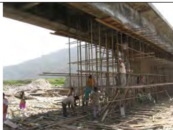
写真-10：道路局によってメラムチ付近で建設中の支間長 28 m、1車線の鉄筋コンクリート橋、本プロジェクトで同様の 形式の橋を3箇所建設する計画である。
