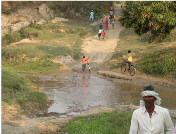
写真-1：マホタリ郡、路線 No.1 ラクマニア-ラグナトプール道路、サイト No.1-2、乾期の終盤 2009 年 4 月撮影 雨期には通行できない。
