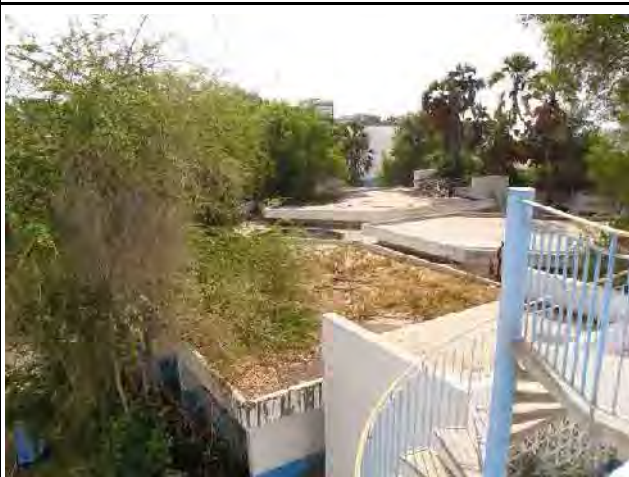
4. 既存教員養成校(CFPEN) 外観 老朽化した建物が狭小な敷地に密集して建てられており、施設内に余裕はない。
