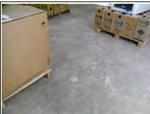
20. GABODE技術中学校 (FADES資金) 2007年9月に開校したばかりなのに、床にクラックが入っている。
