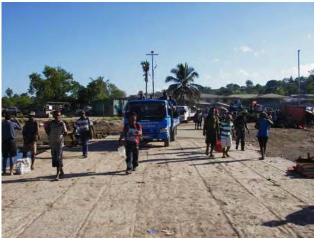
写真-4:既存栈橋では床コンクリートの損傷が激しく、幅員が狭いため混雑する。また杭・梁材は錆びて穴があくなど著しい腐食が見られる。
