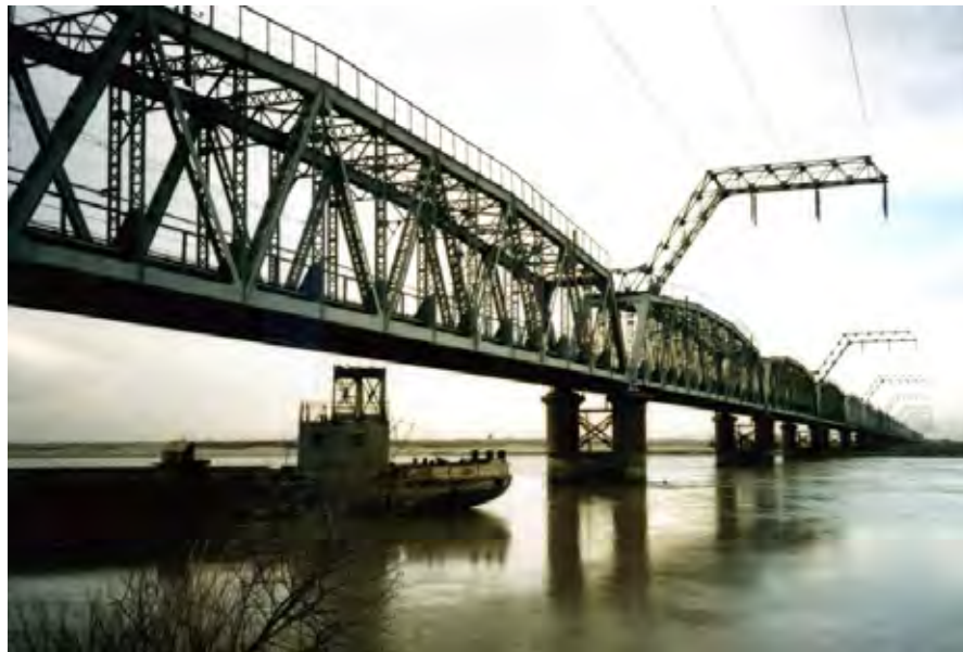
アムダリヤ川に架かるトルクメナバード-ファラップ橋
