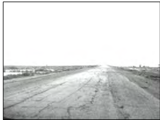
傷んだ路面（テジェン付近）
