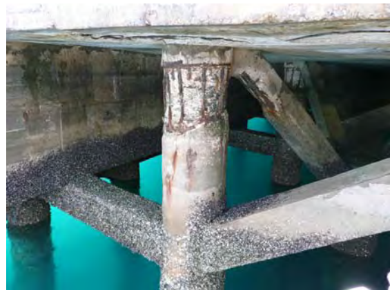
G/C埠頭南端、鉄筋露出・腐食
