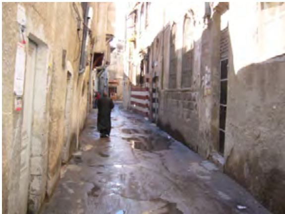
Al Breidi Street (狭幅員のところがあるが、沿道建物の公的取得は進んでいるという)
