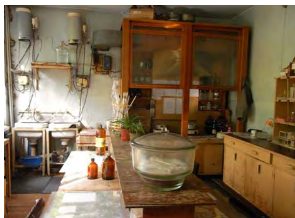
ラボの視察。建物は古く、老朽化が進む。
