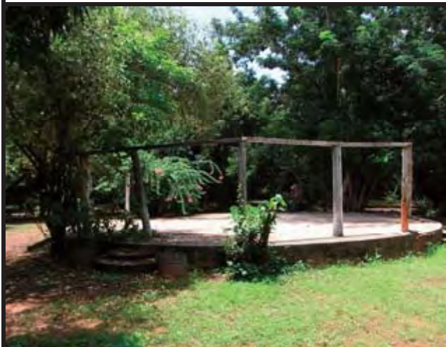
■植物公園内屋根付テラス 1995年に建設され、2008年6月まで使用されてきたが、風害の影響を受け、茅葺屋根が崩壊、それ以来、修復されていない。
