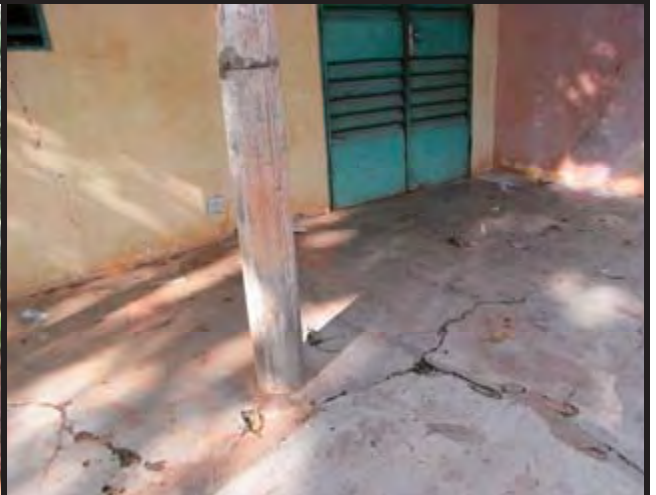
■職員宿舎（棟番号21） 外部テラスの柱は打継部から亀裂が入り、また床スラブも基礎部の施工不良および目地がないための亀裂による損傷が大きい。
