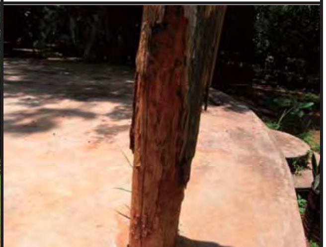
■植物公園内屋根付テラス 柱は木製につき、シロアリの被害が深刻である。
