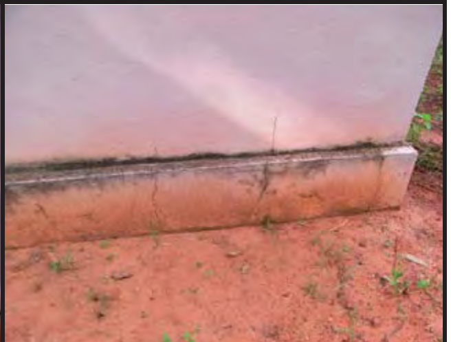
■職員宿舎（棟番号22） 基礎部に入るせんだん状の亀裂は、不同沈下の要因も想定できる
