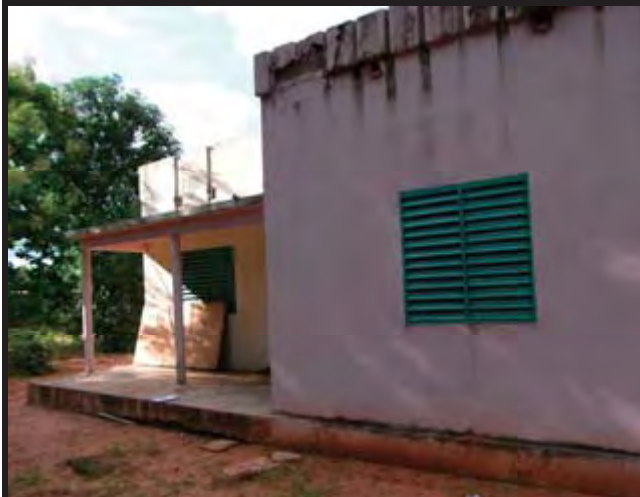
■職員宿舎（棟番号22） パラペット下の水平方向の亀裂が入り、雨漏りの一因となっている。
