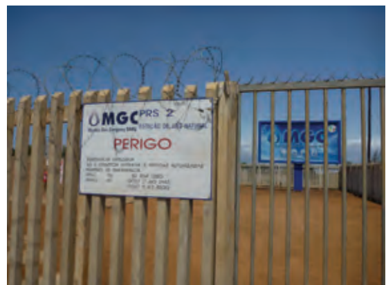
二次減圧設備周囲の柵
