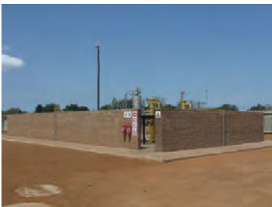
二次減圧設備 (PRS2) 全景
