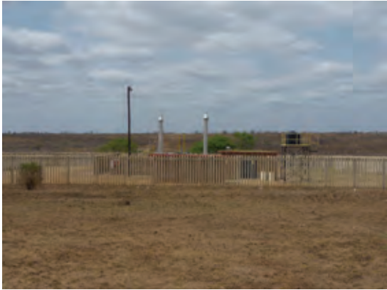
一次減圧設備 (PRS1) 全景
