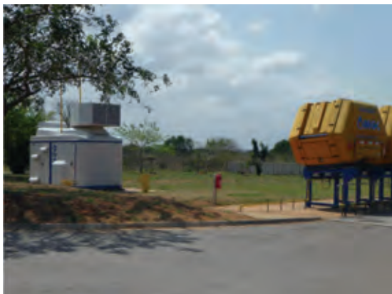
ポンベ充填用コンプレッサー
