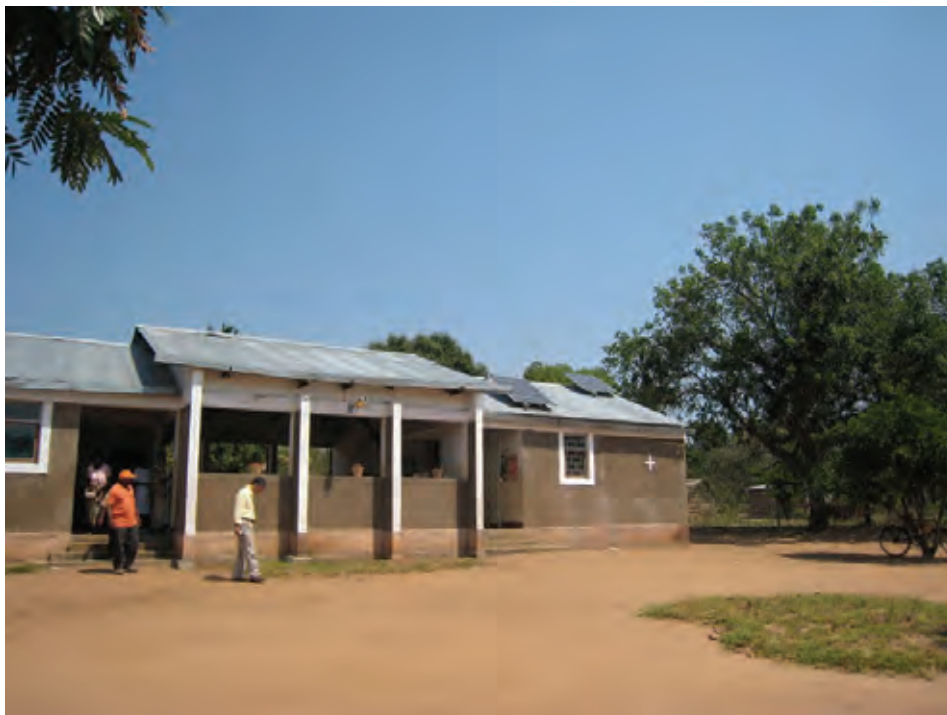
写真 5 - 3 屋根に太陽光パネル（Jangamo District 無電化地域クリニック）
