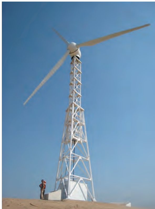
写真 5 - 2 Rocha 海岸付近に設置された 300kW の風力発電設備 (2)
