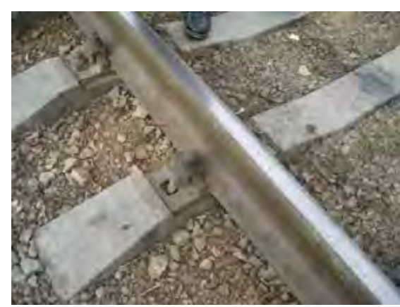
締結ボルトの破損
