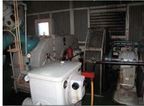
図 10.18 既設 Lusiwasi 発電所の水車発電機
