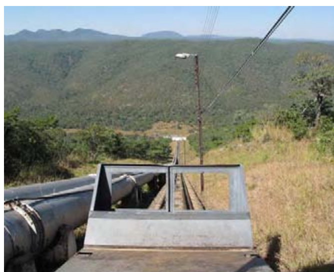
図 10.16 既設 Lusiwasi 発電所水圧鉄管
