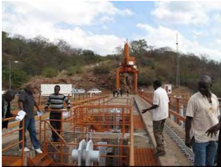
図 10.3 放水路トンネルゲート（将来取水口ゲートとして使用する計画）
