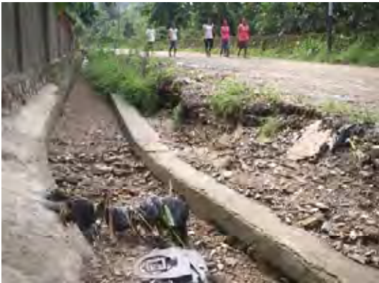
ディリ市内道路の排水側溝の現況。 側溝が土砂で埋まっている。
