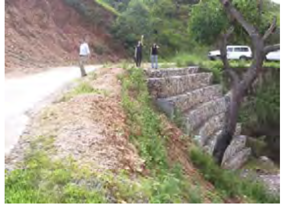
国道山岳部の法面崩壊の蛇籠による補修箇所。今後、写真手前の法肩が崩壊すると思われる。
