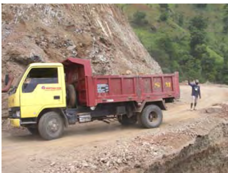
山岳道路施工現場での資材積卸し状況 写真右奥のカーブから進入する一般車両 に対する作業明示がないため、
