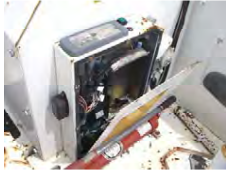
採石プラントの操作部電気回路。 回路部の蓋が開けられたままとなっている。
