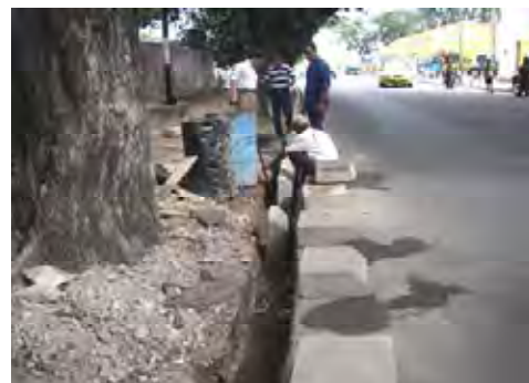
ディリ市内の歩道縁石敷設状況 作業帯の明示がないため、車両・歩行者の 接触・転倒事故の危険性が高い。
