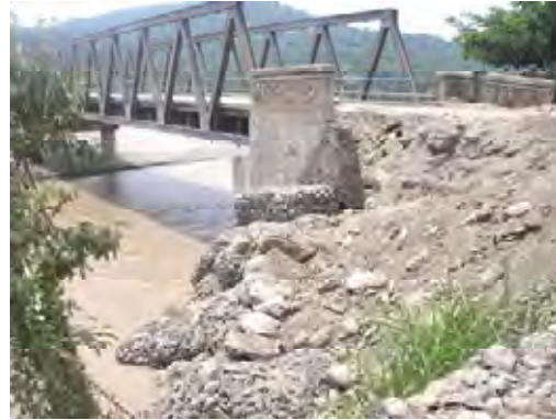
Loes 橋右岸アバット取付部の洗掘箇所 国道 A-03 号線
