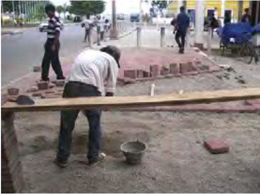
ディリ市内道路の維持管理状況。 歩道部のインターロッキングブロック敷設状況。
