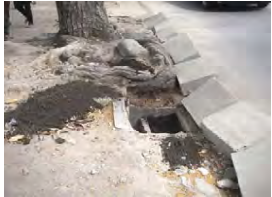
ディリ市内道路の維持管理状況。 歩道部縁石の据付け状況。
