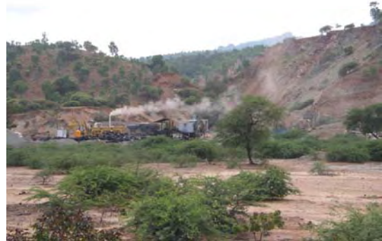
ディリ郊外の民間アスファルトプラント。
