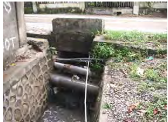
ディリ市内道路の付帯埋設物。 衝撃や紫外線に弱いPVC製の水道管が露出している。
