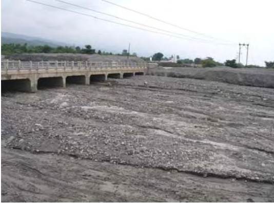
国道の河川横断部の河床。 (河川内の土砂堆積が進行している)
