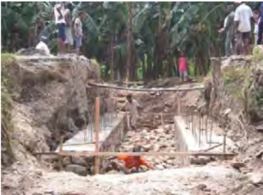
橋梁の補修（改修）工事状況。 下部工は石積構造、上部はRCスラブ構造。
