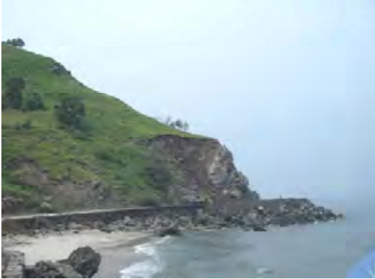
国道海岸部の法面崩壊の状況。
