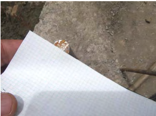
橋梁の補修（改修）工事状況。 下部工は石積構造の補強筋の断面径 ( \phi 15mm)
