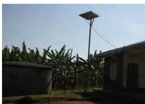
写真-6：ポールマウント式のソーラーパネ ル。パネルの盗難防止に効果的である。
