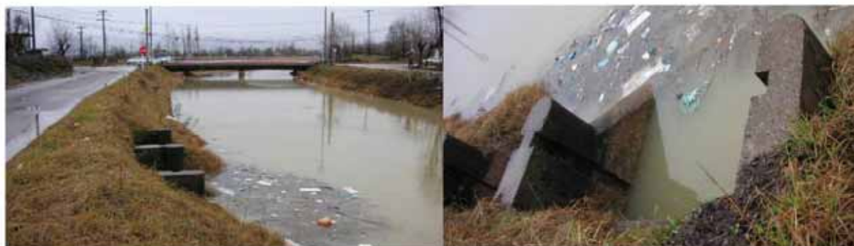
第一次幹線水路から第二次支線水路の分岐点、取水口の状況
