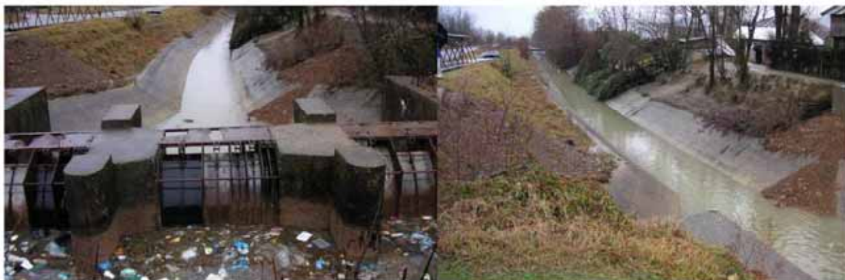
道路を挟んで第二次支線水路のゲートが設置されている。ゲートから第二次支線水路が続く。ゲートの劣化が進んでおり、早急な改修が望まれる。
