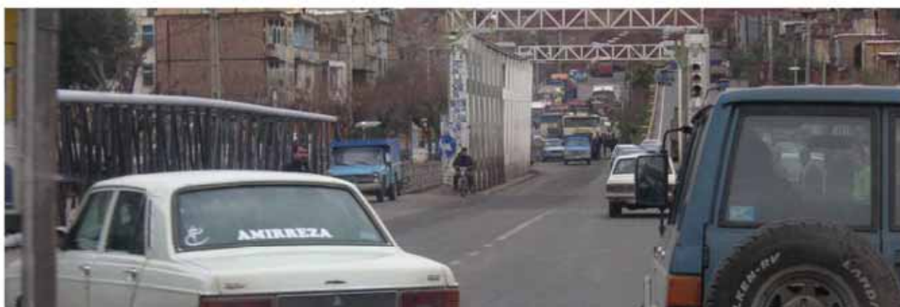
Lowshan 市内で Shahrud 川にかかる道路の橋梁が交通のボトルネックとなり、地域交通渋滞の原因となっている。また、同じ場所で川幅が最も狭くなっており、橋脚などの構造物が流下能力の制限要因となっている。
