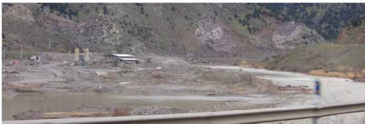
ダム下流の Sefid rud 川本川の河川敷内で道路工事用骨材を採取するプラント
