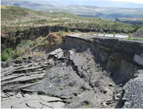
Station 22 の地すべり状況
