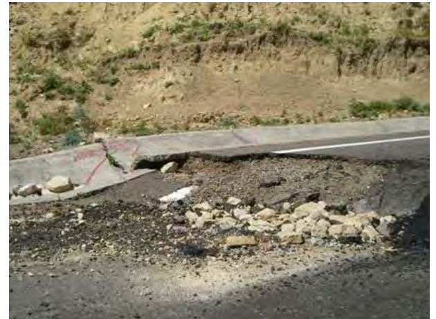
Station 28 における地盤隆起とクラック
