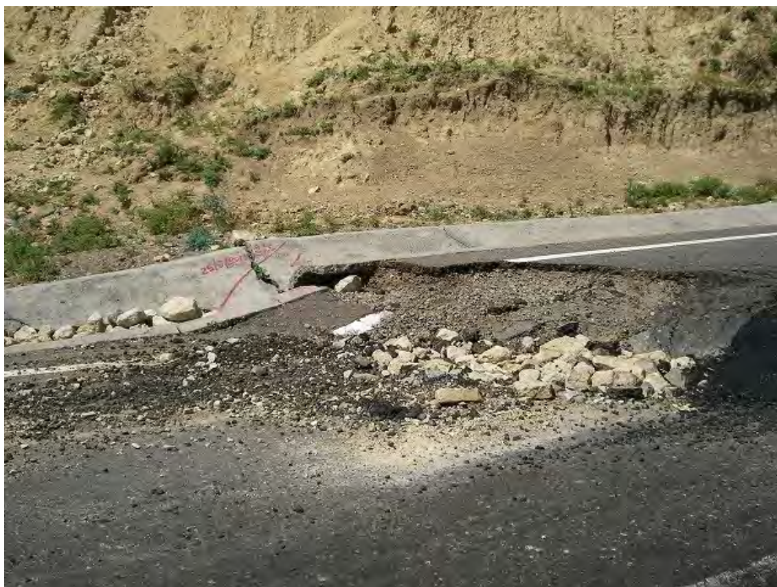
写真6 ステーション 28 の亀裂及び段差
