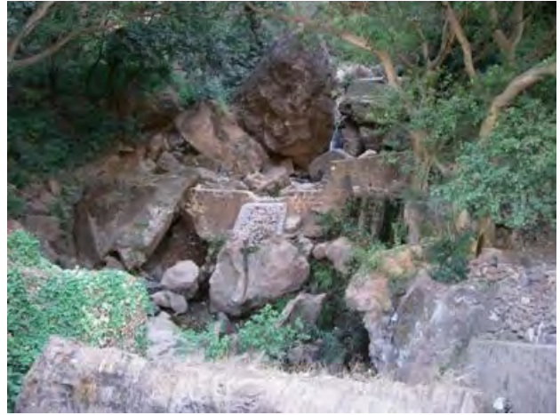
Station 17 における落石
