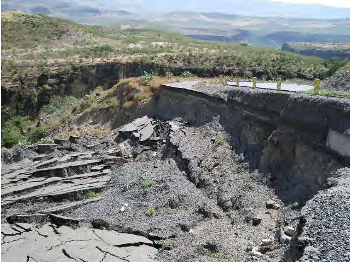
写真5 ステーション 22 の地すべり状況
