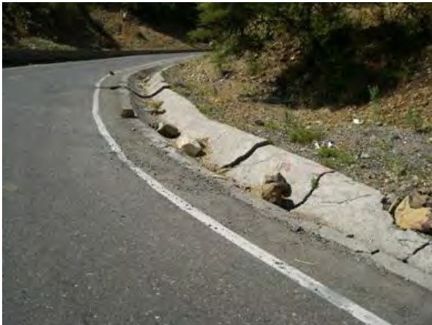
Station 27 における側溝のクラック
