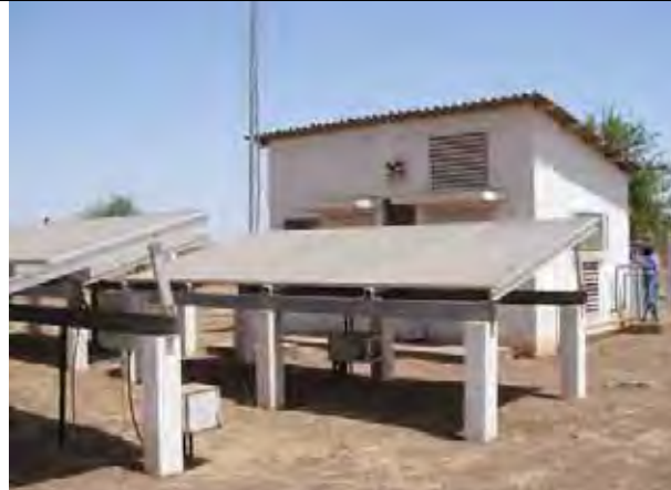
写真-10 タンバクンダ州(TA-03) Kalbiron (1) 1995 年に井戸建設。PEPTAC 対象村落。日本で供与したソーラーパネルが動力源となっている。
