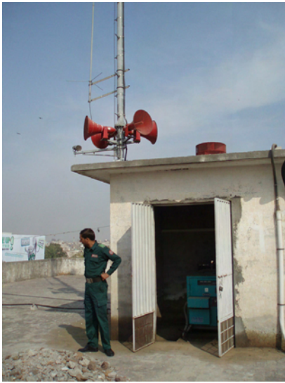
警報局 (屋上に警報サイレンが設置されている)
