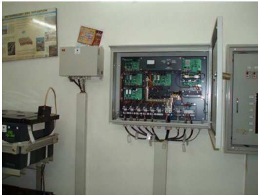
観測所内部の機器
